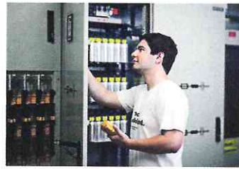
Damit das Stromnetz nicht unnötig belastet wird: Ermitteln des Blindstromanteils zur Optimierung einer Kompensationsanlage
